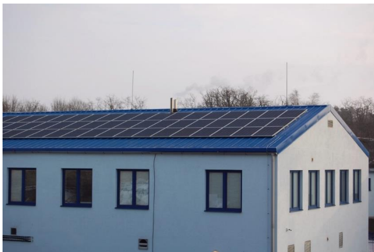
Fotovoltaické panely na střeše budovy v areálu TEDOM Výčapy
